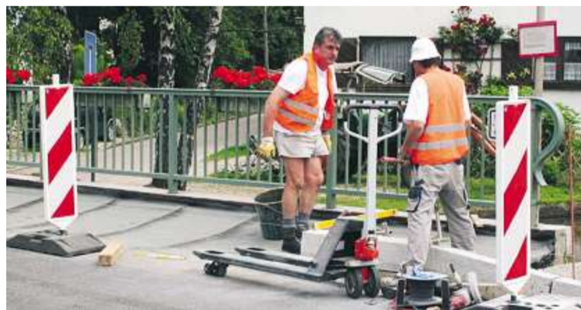
Die Gehsteige wurden komplett entfernt, um den Unterbau zu sanieren. Zwischenzeitlich wurden die neuen, aus Sicherheitsgründen wieder erhöhten Gehwege fertiggestellt. Foto: ufb
